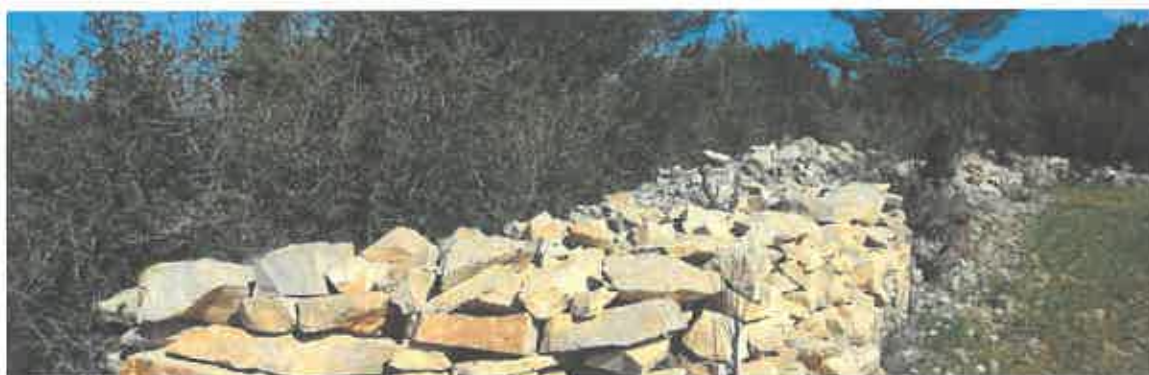
Exemple d'un muret embroussaillé sur sa partie gauche (et dégagé à droite, hors périmètre de la compensation) – CBE, 2018
